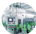
Minuterie de puissance, solénoïdes et contrôleurs
